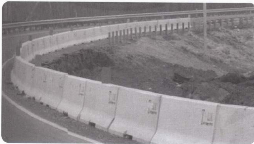
รูปที่ ๗ การติดตั้งราวกันอันตรายแบบคอนกรีต
